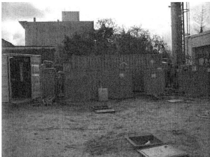
Photographie 1 : unités de traitement de l'air et l'eau
